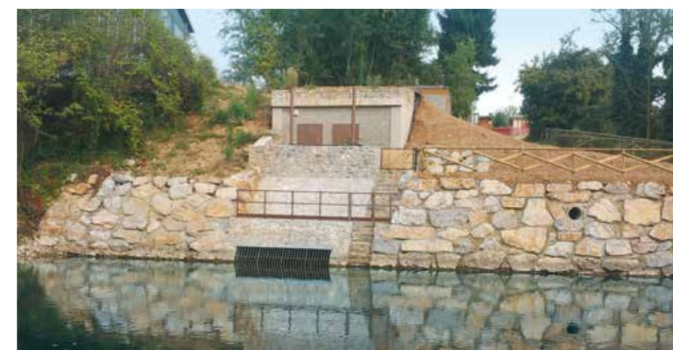
Sollevamento mediante pompe dal fiume Serio per la Roggia Borgogna in comune di Scanzorosciate
