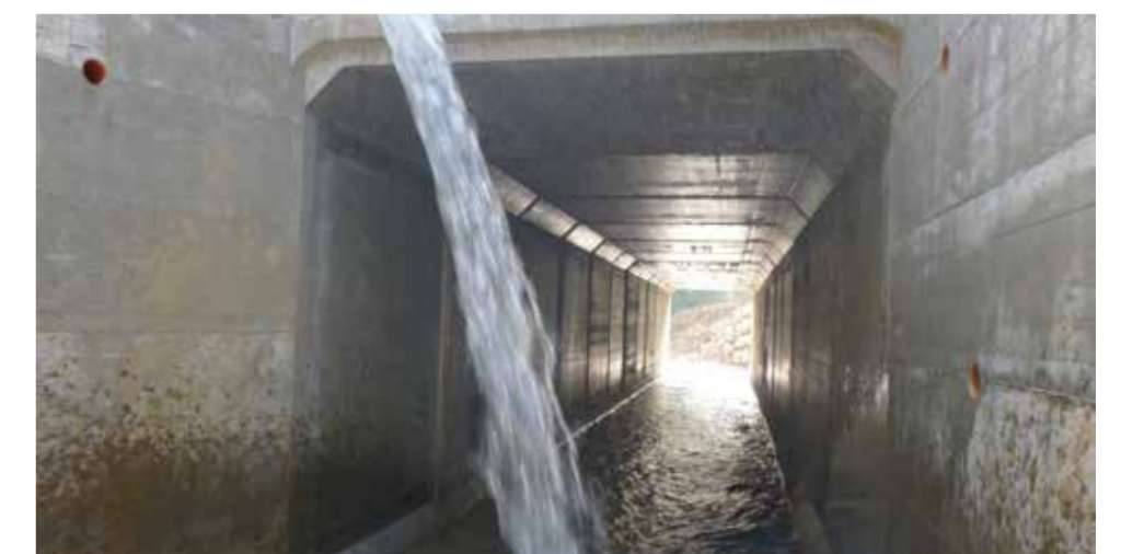
Il sottopasso del torrente Zender con lo scarico dell'impianto pluvirriguo dell'Isola bergamasca fra Bottanuco e Suisio.
