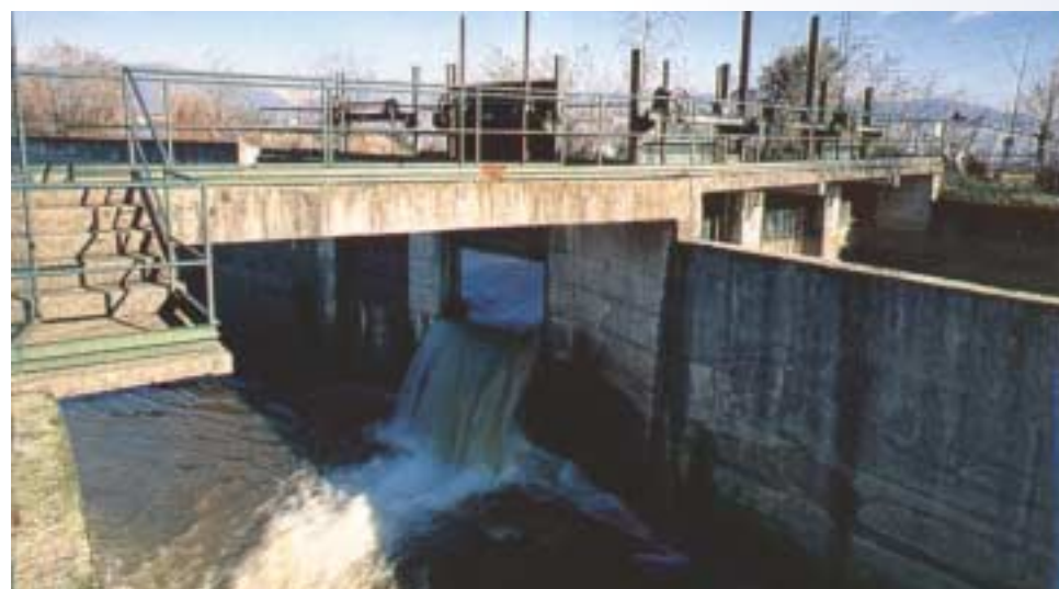
Paratoie e meccanismi di deviazione del canale scaricatore del torrente Zerra
