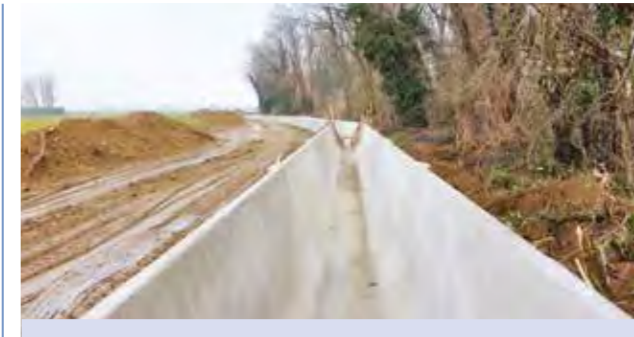
Canalizzazione in prossimità del fontanile denominato "Fontanone Campo Rosso" in comune di Martinengo
