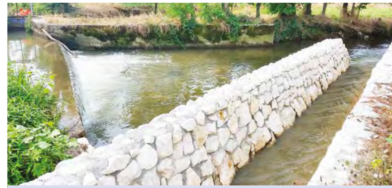
Ripristino manufatto di scarico nel fosso Bergamasco in comune di Romano di Lombardia
