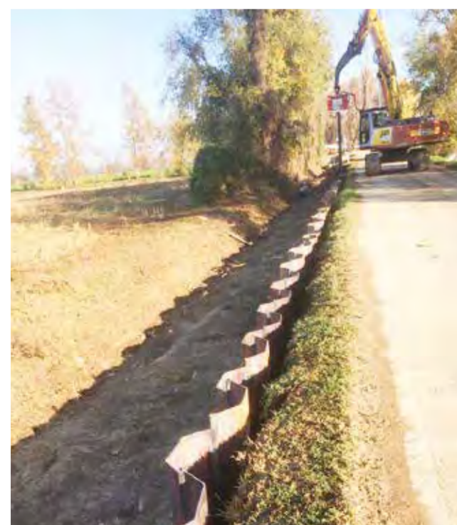
Operazioni di infissione palancole per consolidamento spondale in comune di Cavernago lungo il lato ovest ex S.P. n. 96
